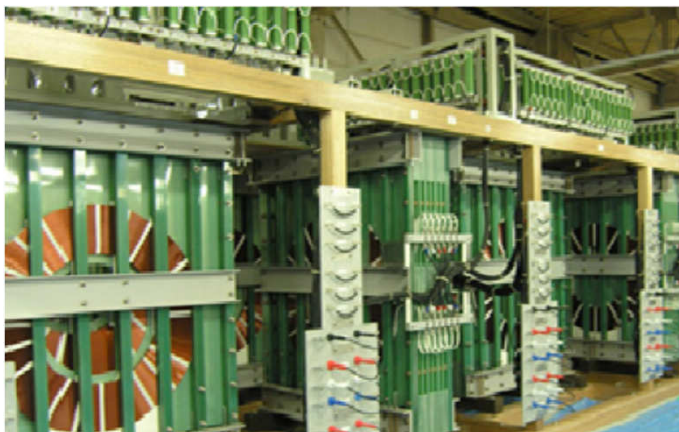
＜アナログ模擬送電線設備＞
