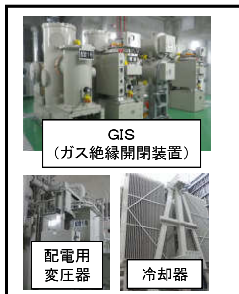
1F(GIS室, 配変室, 冷却器)
